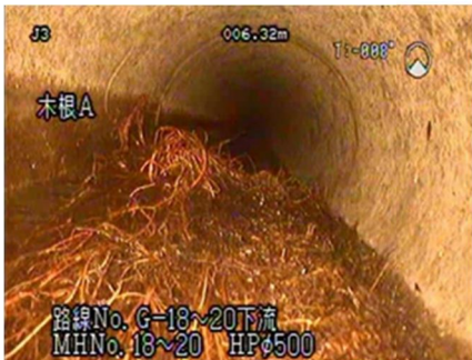
○小金井団地排水管内木根侵入状況
